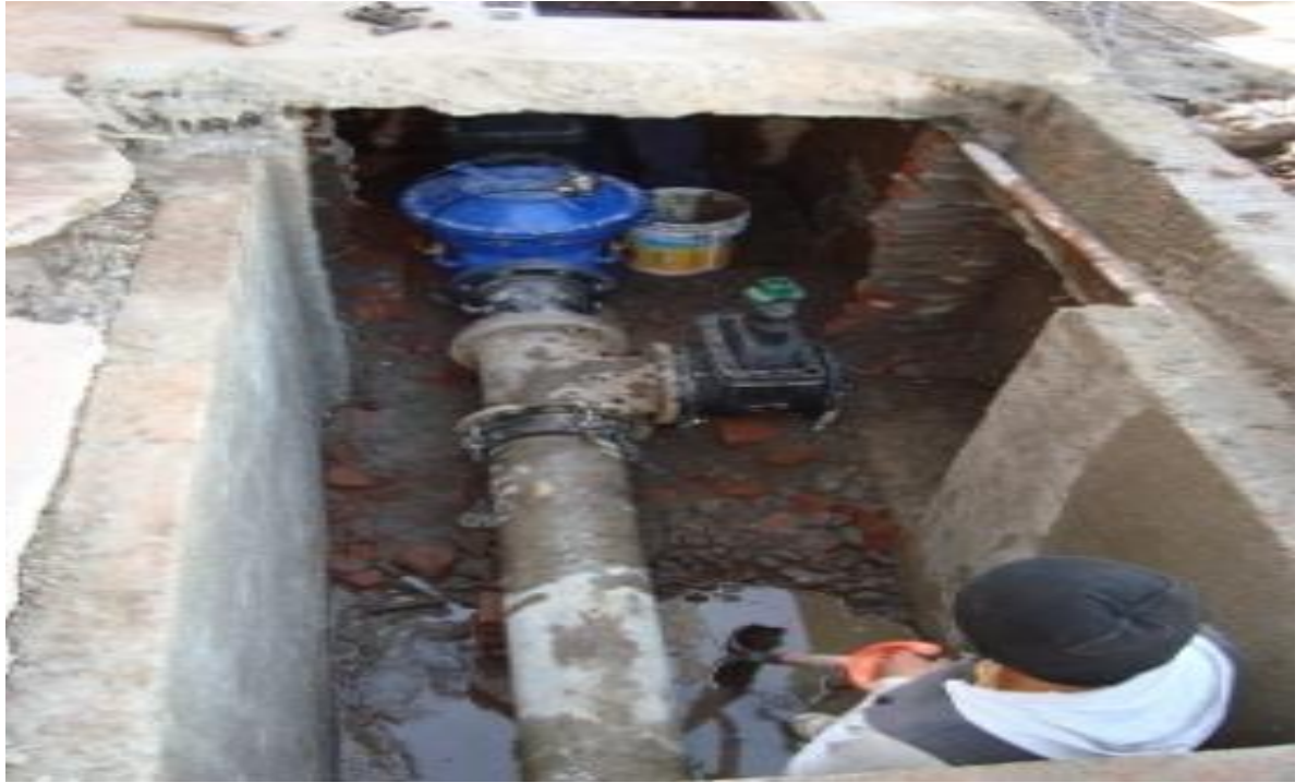
Figura 7. Antigua instalación del tren de válvulas.
