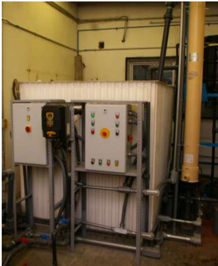
Figura 4. Foto de los gabinetes de control.
